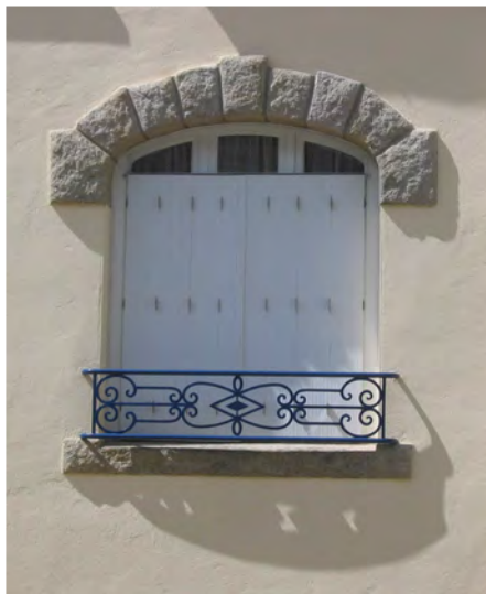
Persiennes repliables en tableaux de baie.
